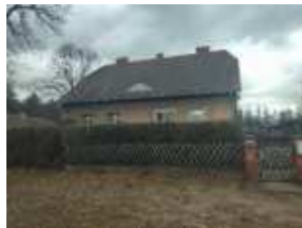
Unsanieretes Wohnhaus in Hobrechtsfelde. Quelle: mellon
