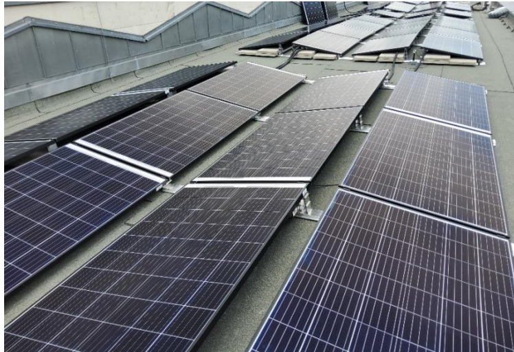
Abbildung 3: PV-Anlage auf dem Rathaus
